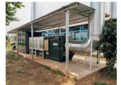
喷漆废气处理系统
