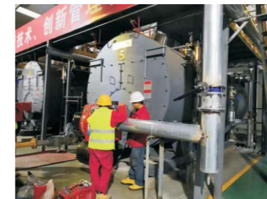
锅炉低氮改造
